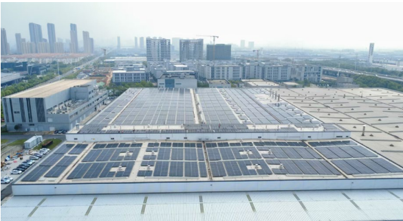
◆ 旗下智新科技股份有限公司光伏建设
